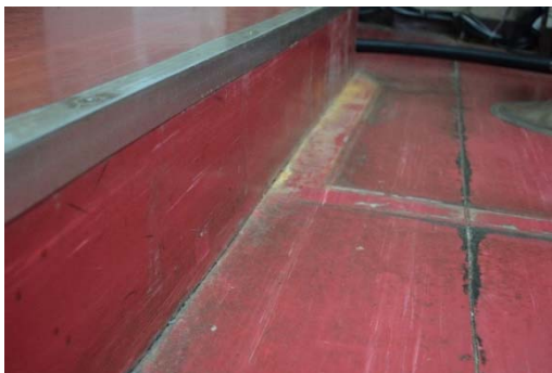
地板變形、龜裂。地科院提供
