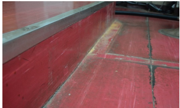
地板變形、龜裂。地科院提供
